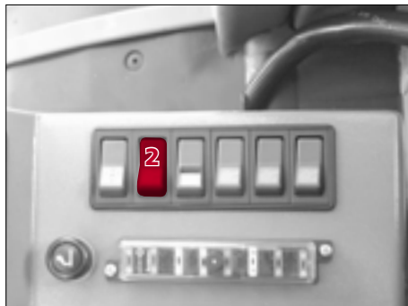
Fig. - 54 Kontakt til svingningsdæmpning af løftestellet
